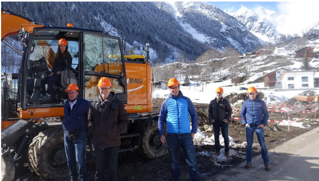
Der Vorstand der Wohngenossenschaft Fieschertal Rissla trifft sich mit der Bauleitung zum Spatenstich. Quelle: pomona.media
